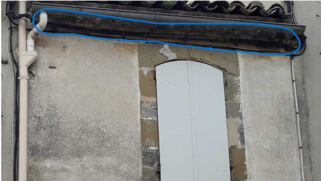
Figure 3 – Génoises entièrement bouché avec du ciment © LPO
